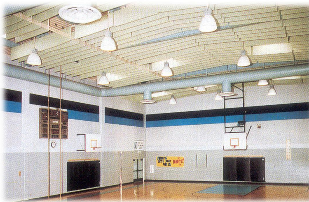
Figura 6.10 – Exemplo de sistema adequado de ventilação. Interior de um Pavilhão. Foto retirada ( www.fotosearch.com )
